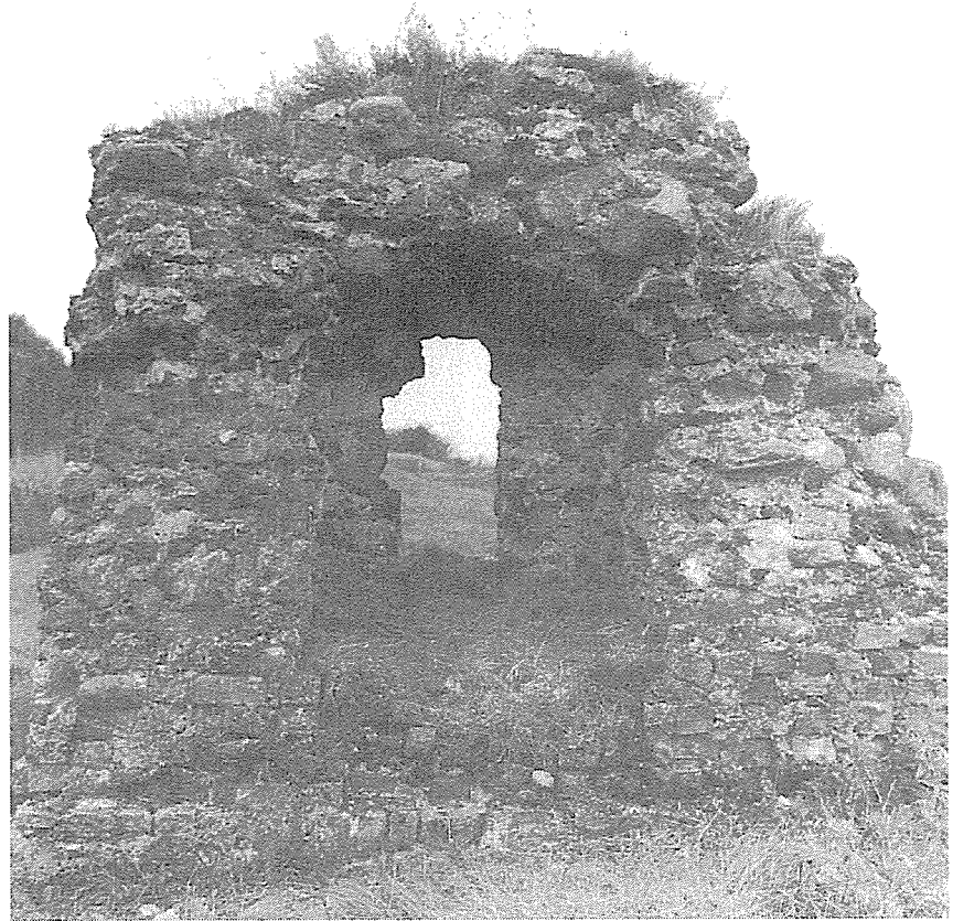
Nordre skydeskår i vestre flankemur før restaurering
